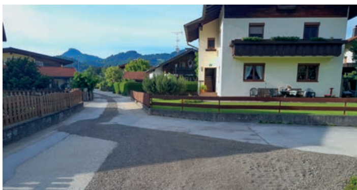
Bei der Kreuzung Ludwig-Steub-Straße/Weidach wurden zwei Einlaufschächte vorgefunden, die falsch angeschlossen waren.
